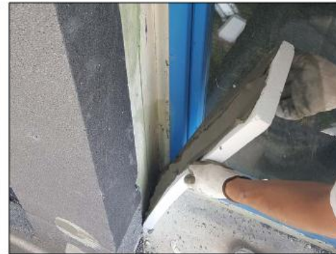
Posa del risvolto dell'isolante esterno in EPS bianco sulla spalla degli infissi.
