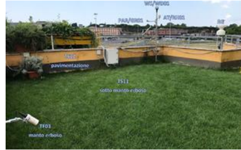
Sensori disposti a livello di tetto verde
