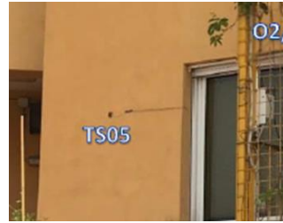
Sensori disposti a livello di parete dell'edificio
